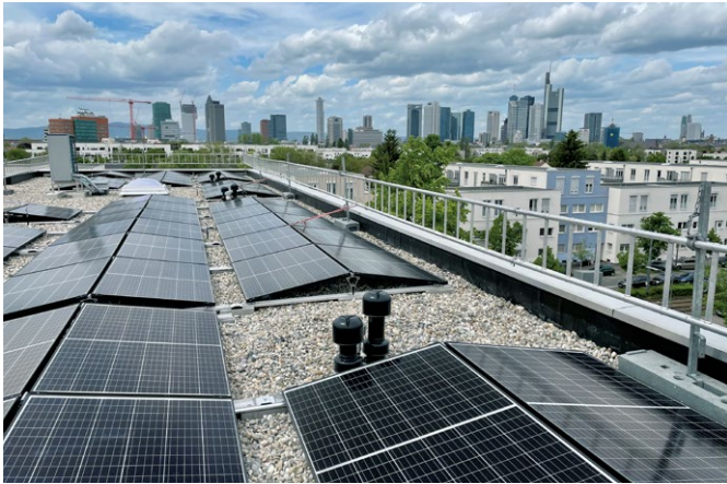
Abb. 3: Photovoltaikanlagen auf den aufgestockten Dächern in der Fritz-Kissel-Siedlung (Foto: NHW)
